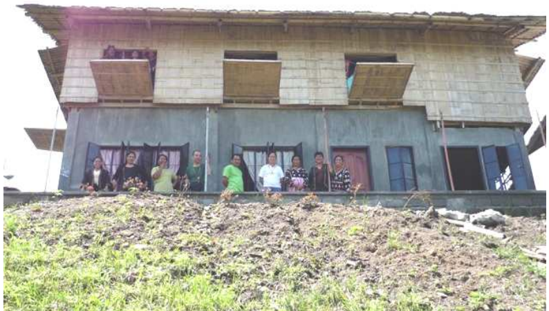
1階が事務所と研修室。まだ外壁塗りが終わっていません。湖側より撮影。
